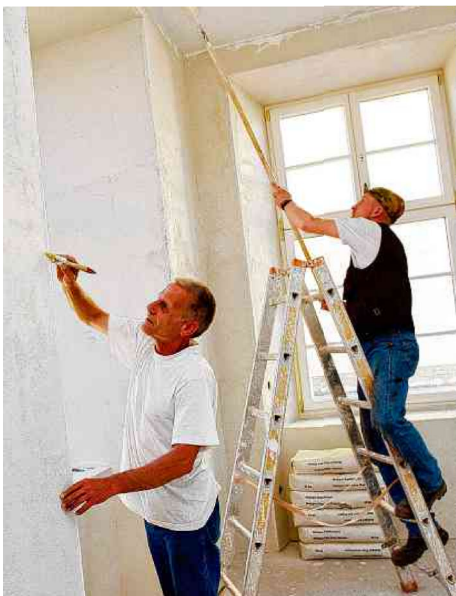
Ralf Heimler (li.) und Benedikt Wilke verpassen einer der neuen Wohnungen im Walbecker Sonnenschloss den weißen Anstrich.
